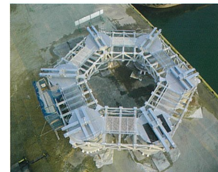
六角形発電施設浮体全景
