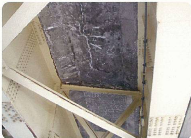
RC床版損傷状況
