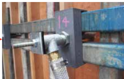
写真-3 セパレータ兼用クーリング注水口
