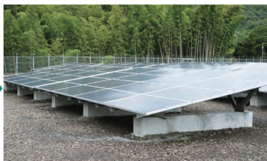
⑪ ソーラーシステム設置状況
